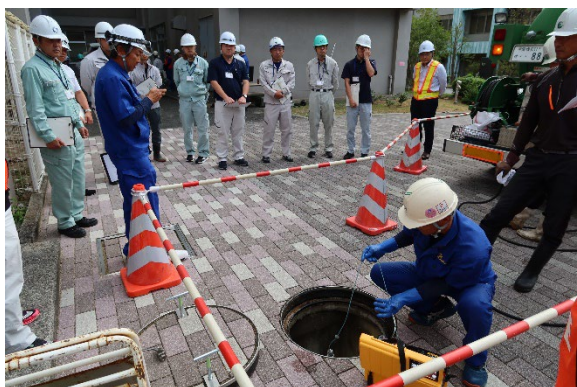
下水道（愛媛大学城北構内）
