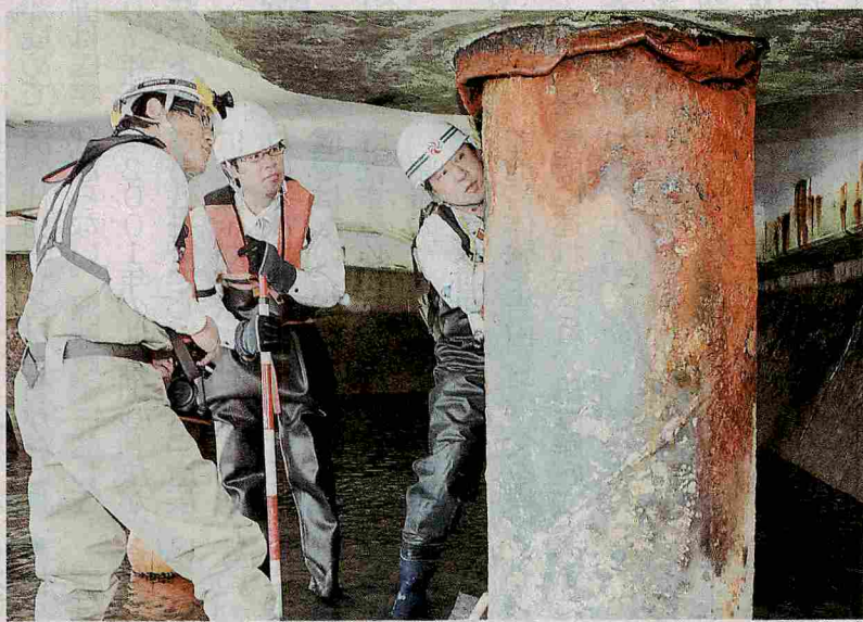
臨港道路が沈下した由良港で腐食して変形したくいを調査する県や大学の関係者ら＝1月10日、松山市由良町
