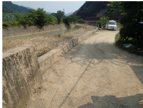
写真⑱(堤防の越流跡)
