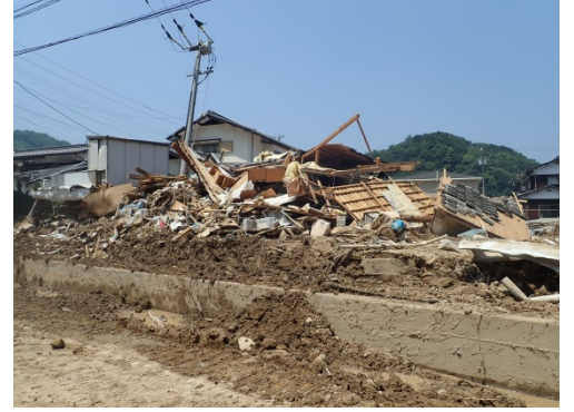
写真⑨(家屋崩壊)
