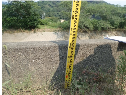
写真⑰(堤防の土砂痕跡)
