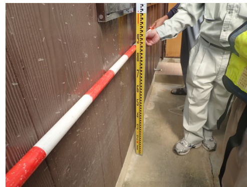
写真⑨(民家壁)
