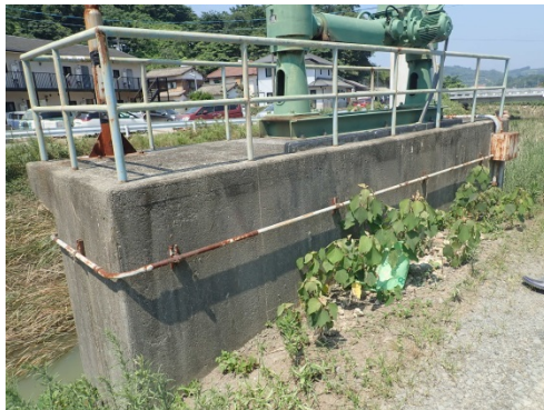
写真⑪(ポンプ)
