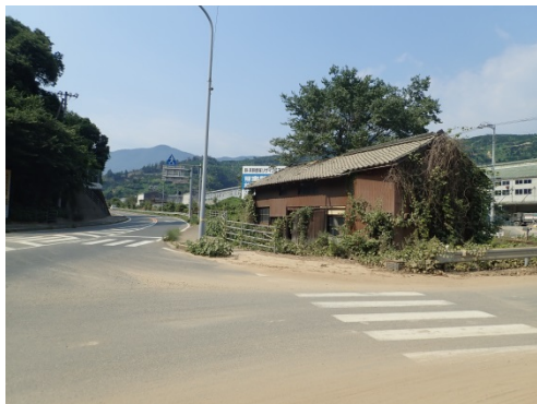
写真⑬(家屋崩壊)
