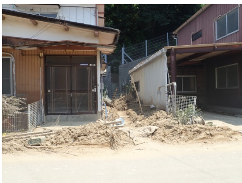
写真⑯(土砂崩れ跡)
