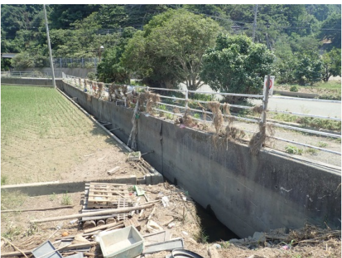
写真⑩(仕出橋左岸北側道路)
