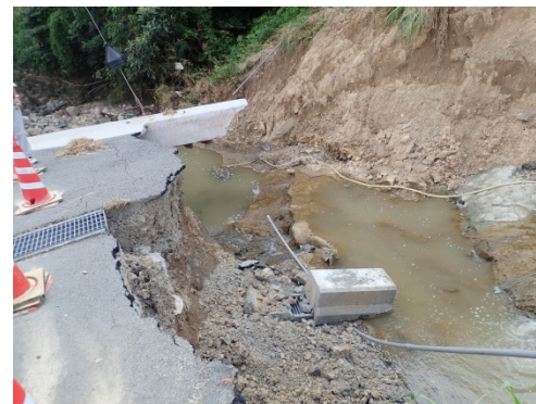
写真③(ため池決壊部)
