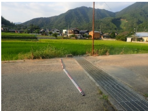
写真⑰(街灯横浸水跡)
