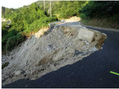
道路盛土斜面の崩壊 (大島・吉海町田浦)
