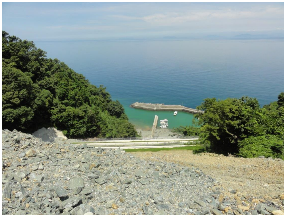
県道 255 号線亀浦トンネル (2018年3月開通) 西側から伊方越漁港を望む
