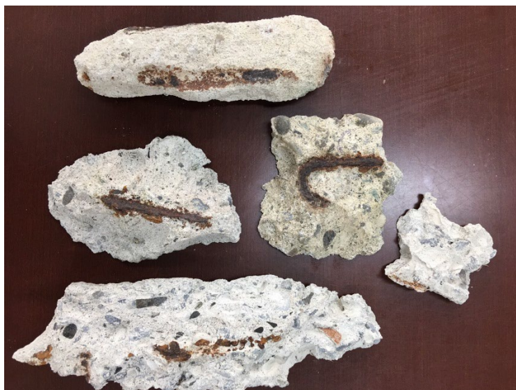
写真 2-1 コンクリート破片
